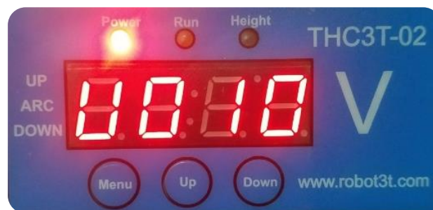
Fig16. Voltage set-point parameter
